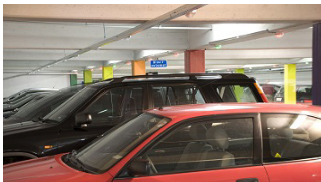
Fig. 34 : Capteurs installés sur plateau de câbles
